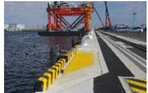
岸壁際のコンセントボックス（例）
