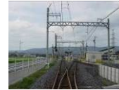
行き違い設備
