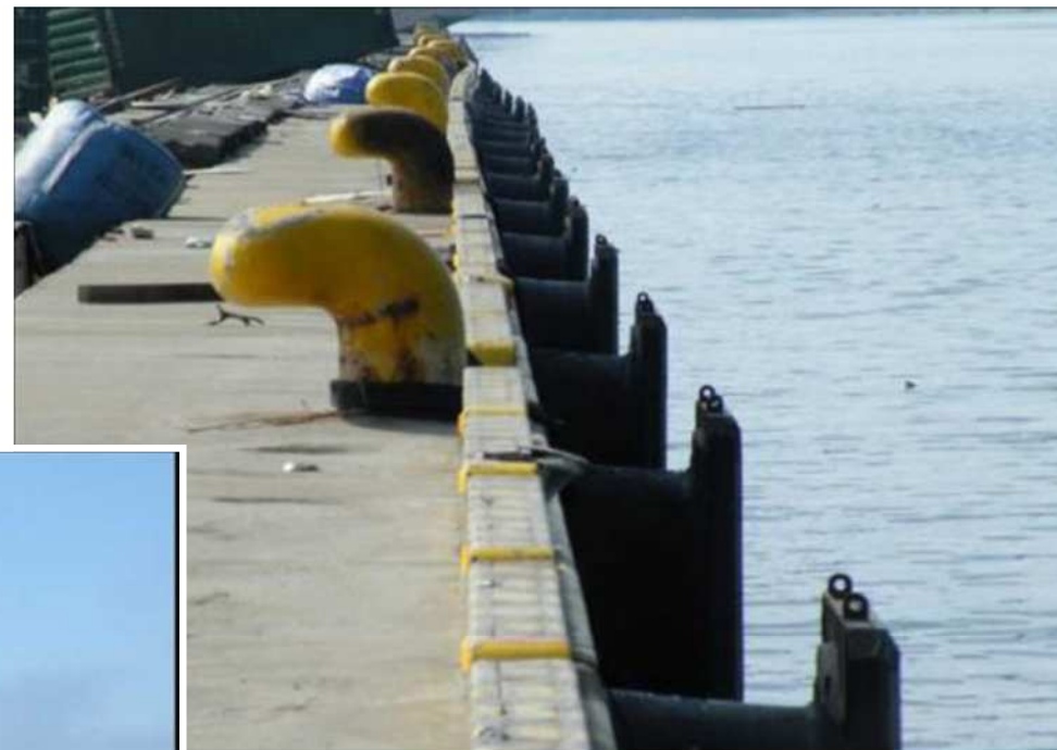
法線のはらみ出し
