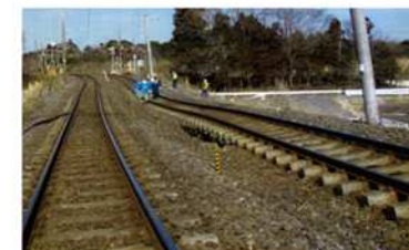
JR常磐線 水戸～勝田間 (盛土沈下)
