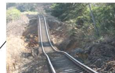
鹿島臨海鉄道鹿島臨港線 鹿島スタ～神栖間 (路盤軌道流出)
