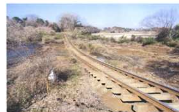
ひたちなか海浜鉄道 金上～中根 (道床流出・法面崩壊)
