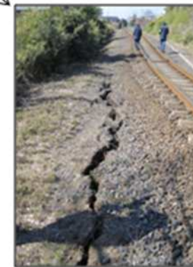
施工基面の亀裂
