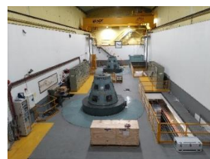
発電用ジェネレーター2基
