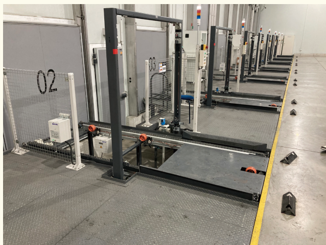
冷凍庫への自動搬入装置
