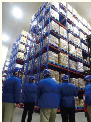
冷蔵倉庫内（室温5℃）
