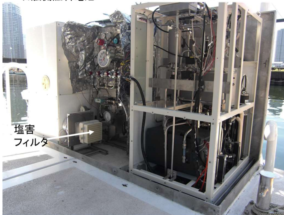
左舷側燃料電池
