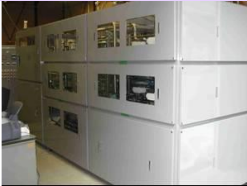
30kW級燃料電池システム
