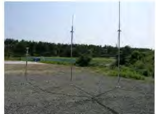
地上局通信アンテナシステム (データ, GPS, 画像)
