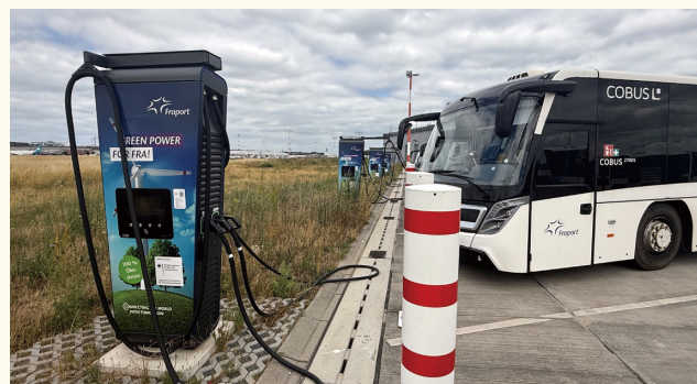
空港内バスの給電施設
