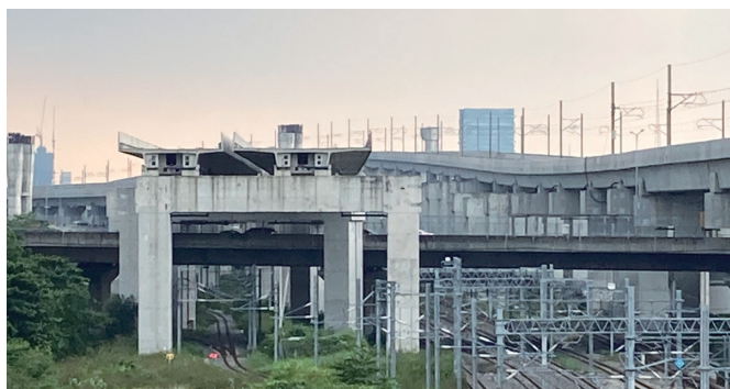
図4 クルンテープアピワット駅 高速鉄道高架橋端部（電気・軌道等設備未施工）
