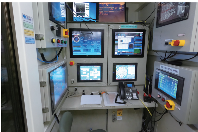
写真8 中央管理室の内部
