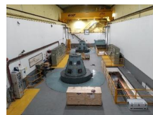
発電用ジェネレーター2基
